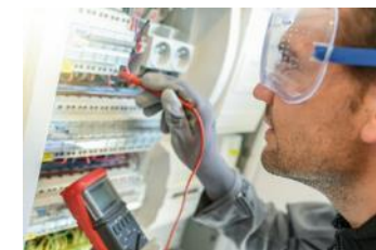
Infrastructure électrique bâtiment
